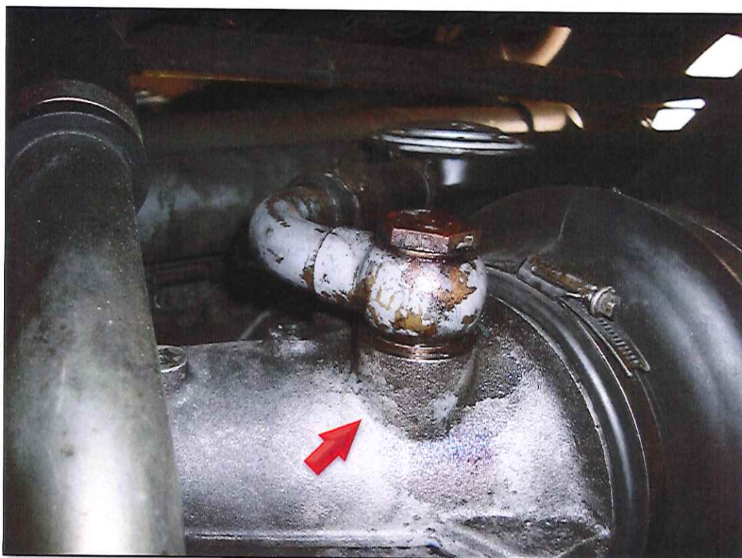
Figura 3. Detalhe do item de check-list #15; vazamento de óleo no filtro do respiro da tampa de válvulas do motor diesel.
