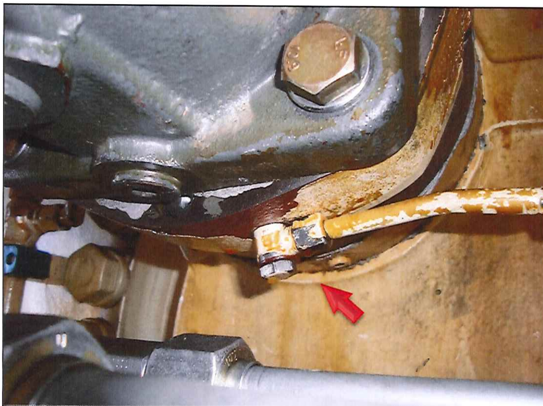
Figura 5. Detalhe do item de check-list #25; vazamento de óleo hidráulico nas conexões dos tubos dos pacotes de freio.
