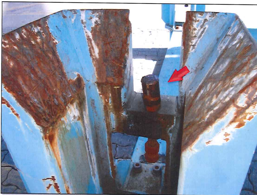
Figura 2. Detalhe do item de check-list #08; pino de acionamento do gancho do lado esquerdo está empenado.
