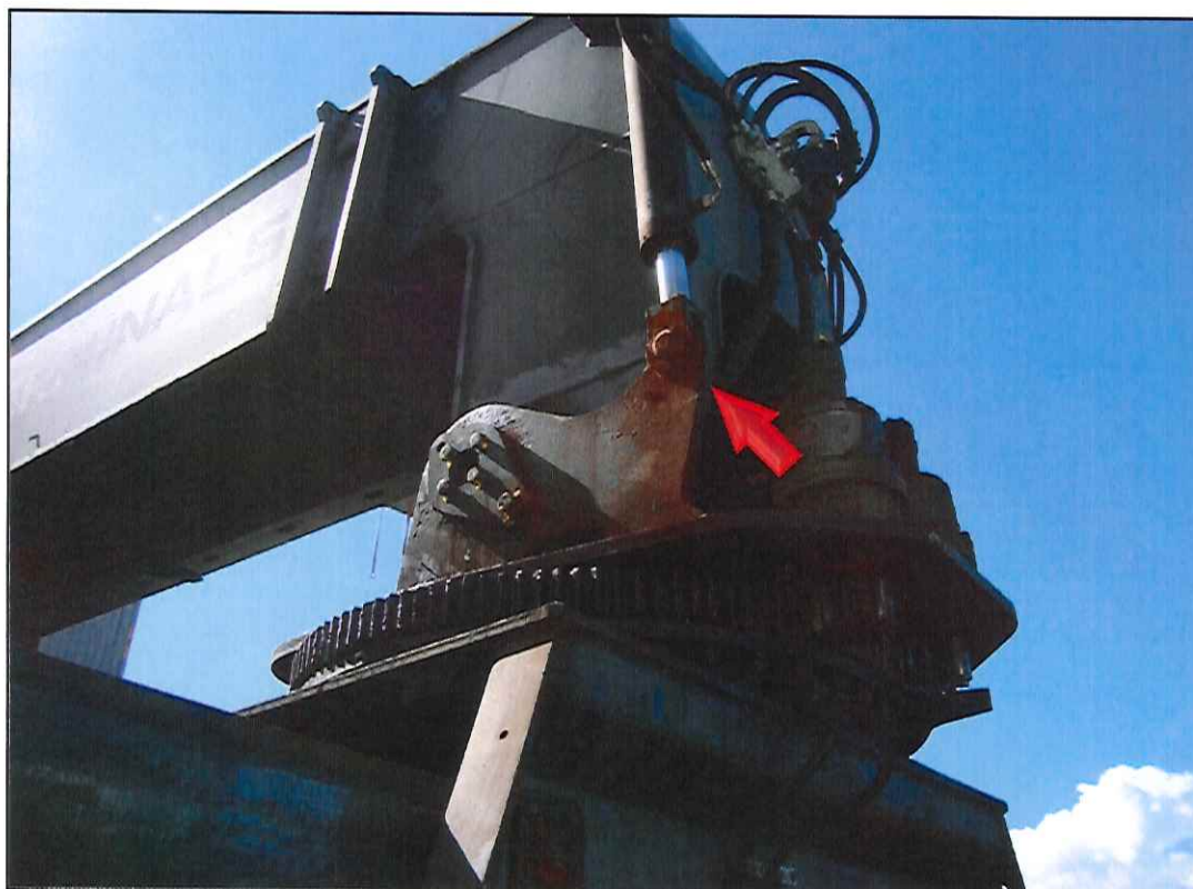
Figura 5. Detalhe do item de check-list #54; cilindro de tilt do spreader do lado direito com olhal inferior soldado.
