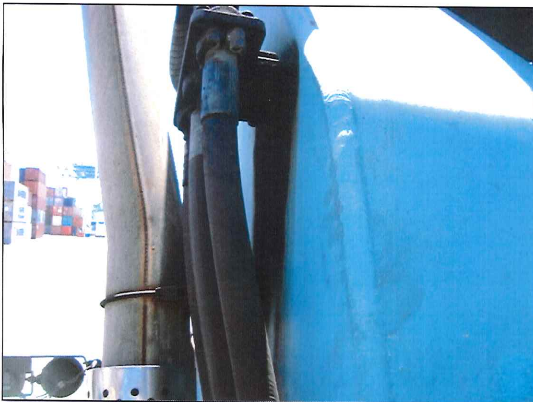
Figura 4. Detalhe do item de check-list #44; vazamento de óleo hidráulico nas mangueiras que sobem pela lança.
