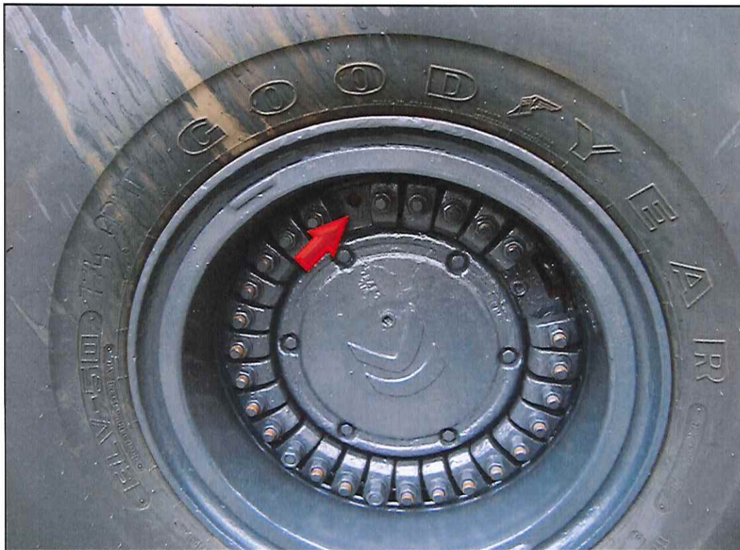
Figura 2. Detalhe do item de check-list #37; ausência de uma castanha na roda dianteira esquerda.
