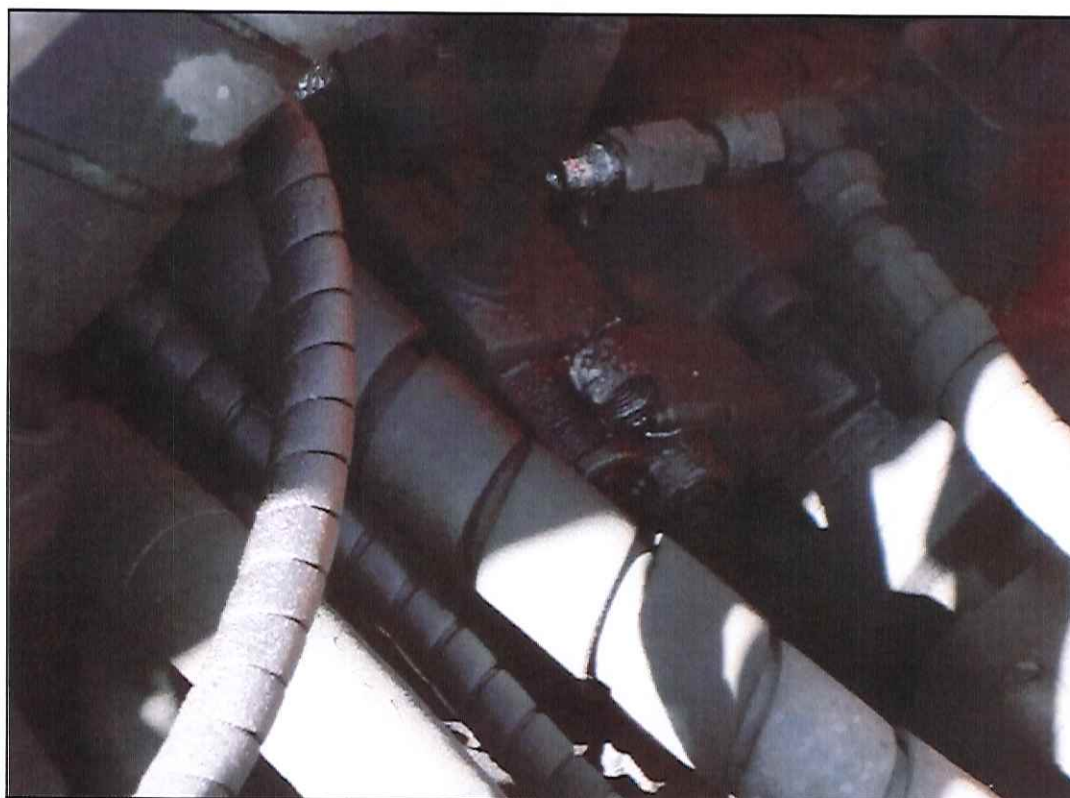
Figura 6. Detalhe do item de check-list #69; vestígios de vazamento de óleo hidráulico no bloco de bombas hidráulicas principais.
