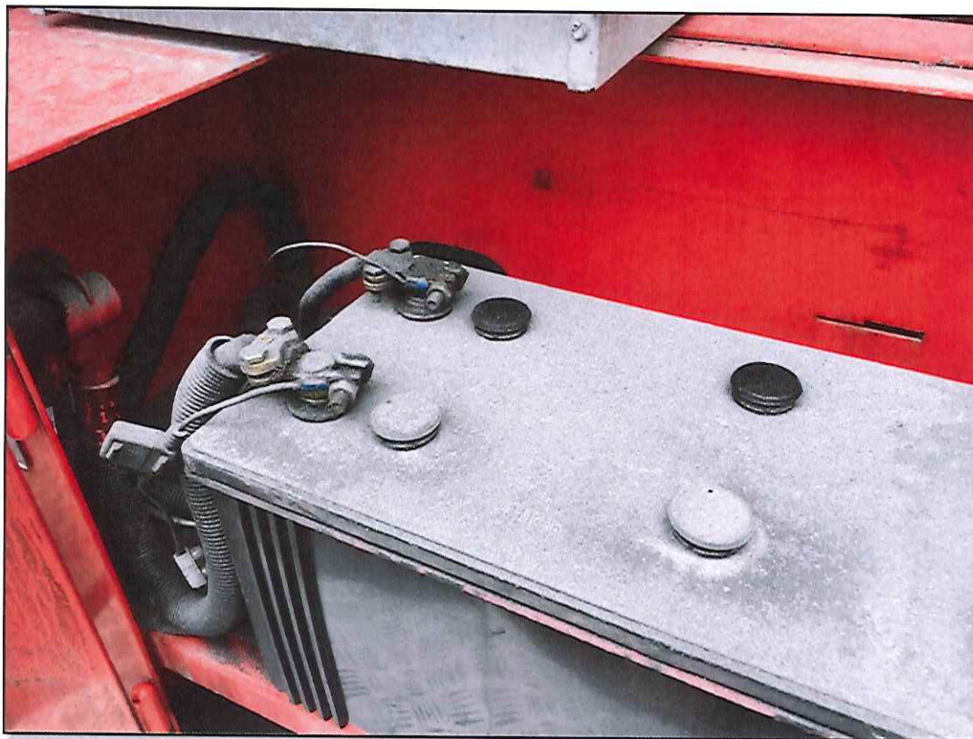
Figura 3. Detalhe do item de check-list #38; cabos das baterias estão sem os protetores de pólos.
