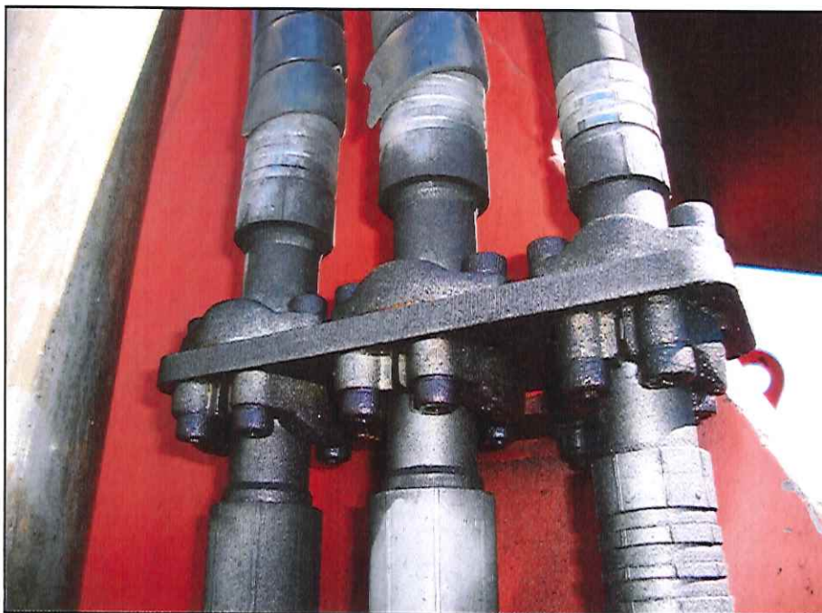
Figura 2. Detalhe do item de check-list #4; pequeno vazamento de óleo hidráulico nas conexões das mangueiras hidráulicas que sobem pela lança.
