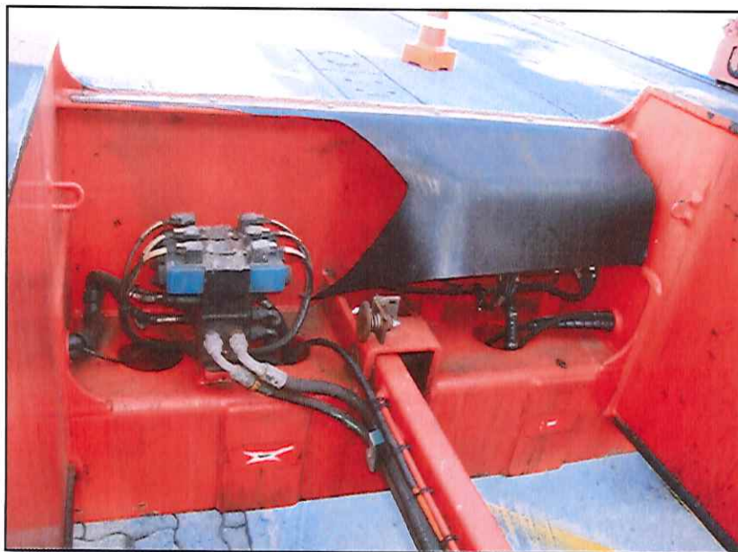
Figura 2. Detalhe do item de check-list #09; borracha de proteção das eletroválvulas desgastada.
