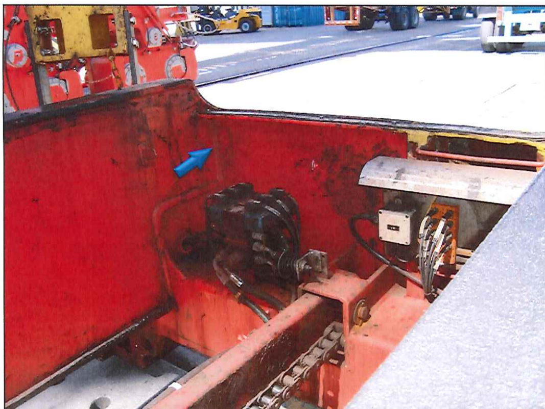
Figura 2. Detalhe do item de check-list #08; eletroválvulas da asa telescópica estão sem a manta de borracha para proteção.
