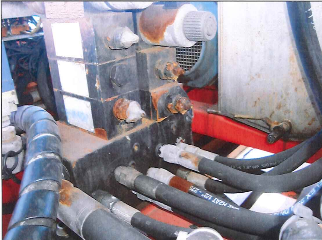
Figura 2. Detalhe do item de check-list #08; blocos de eletroválvulas do sistema hidráulico se encontram oxidados.
