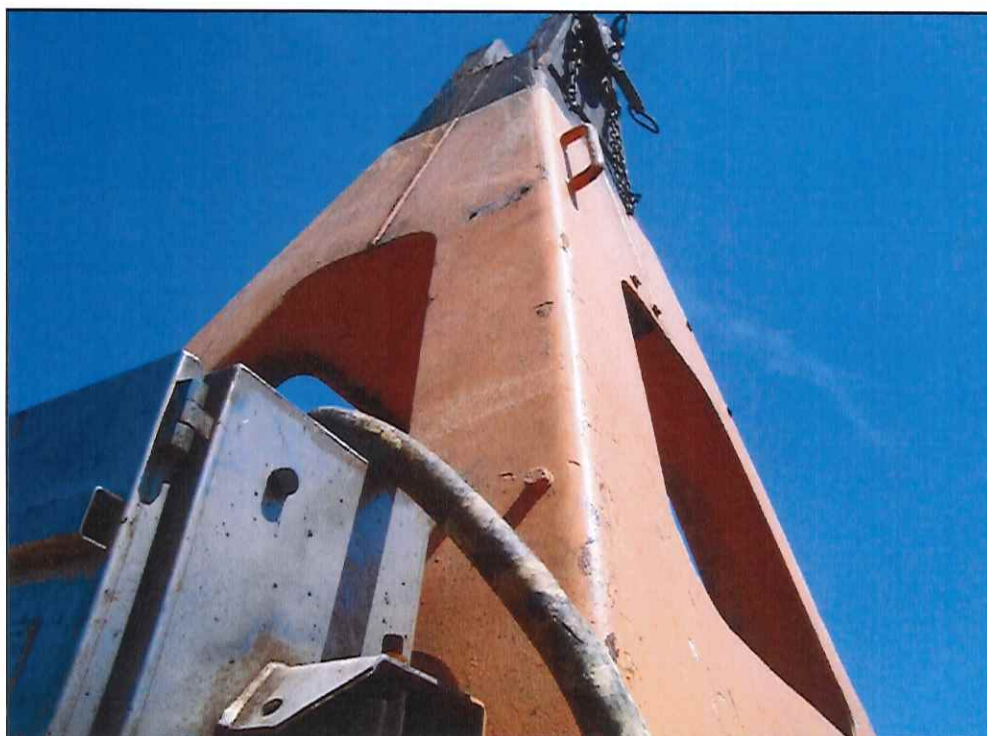
Figura 2. Detalhe do item de check-list #05; necessário melhorar a fixação do cabo elétrico de alimentação do spreader, de forma a evitar avarias.
