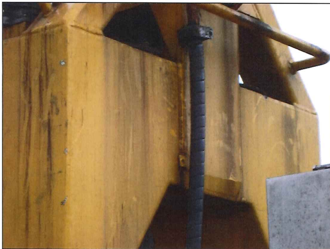
Figura 2. Detalhe do item de check-list #05; faltam algumas abraçadeiras para fixação do cabo elétrico de alimentação do spreader.
