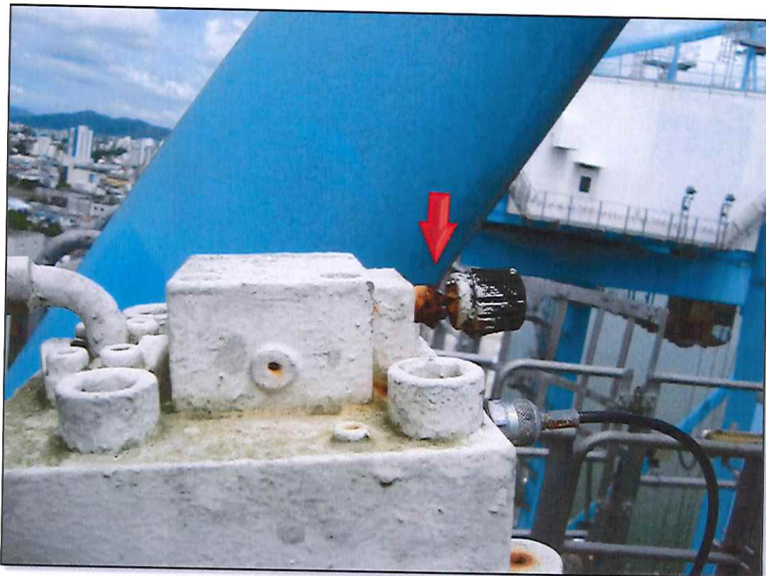
Figura 5. Detalhe do item de check-list #39; válvula do bloco hidráulico da unidade externa do TLS apresenta oxidação.
