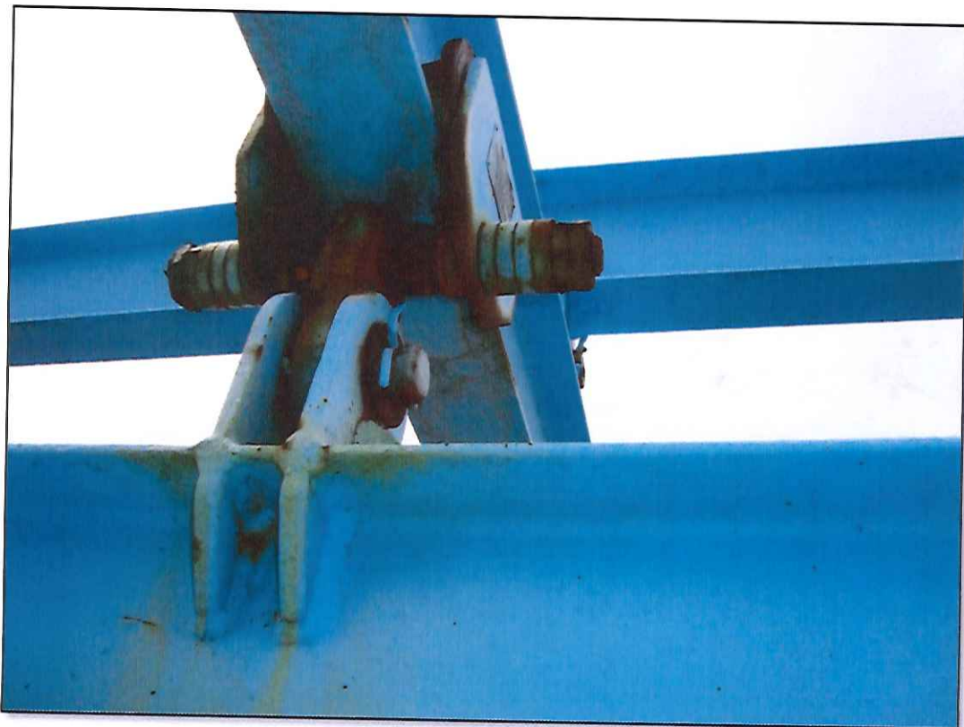
Figura 3. Detalhe do item de check-list #34; dispositivo de fixação do pórtico para içamento de ferramentas da unidade do TLS apresenta oxidação.
