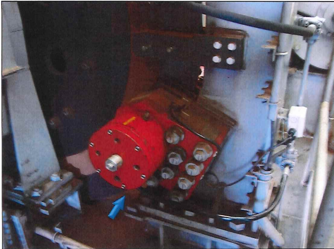
Figura 6. Detalhe do item de check-list #26; pequeno vazamento de óleo hidráulico no atuador de freio de emergência do hoist, lado direito.
