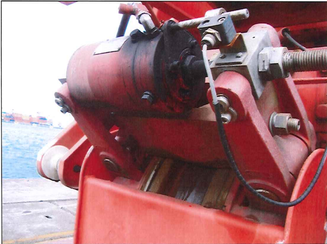
Figura 2. Detalhe do item de check-list #02; unidades de translação do gantry 01 e 08 apresentam vestígios de vazamento de óleo hidráulico no atuador de freio de emergência.
