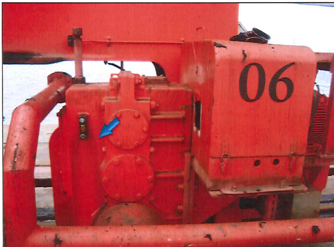
Figura 3. Detalhe do item de check-list #02; vazamento de óleo hidráulico no visor de nível da redutora da unidade de translação do gantry 06.
