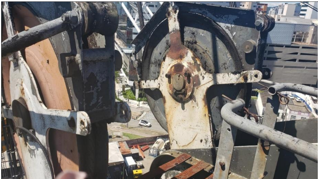
# item 57 – pontos com corrosão no suporte da polia da torre
