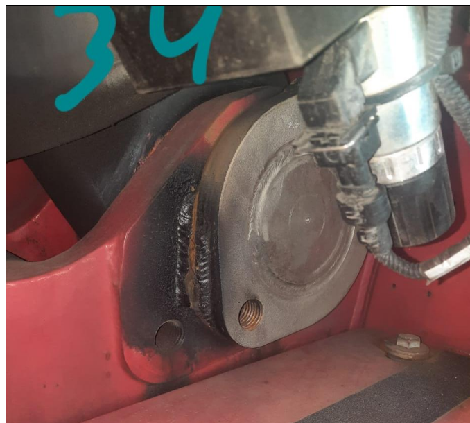
# item 52 – quebra do parafuso de fixação do pino
