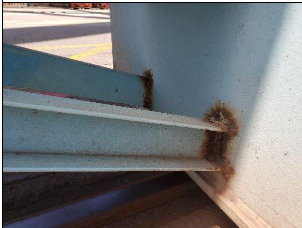
# item 5 – pontos com corrosão
