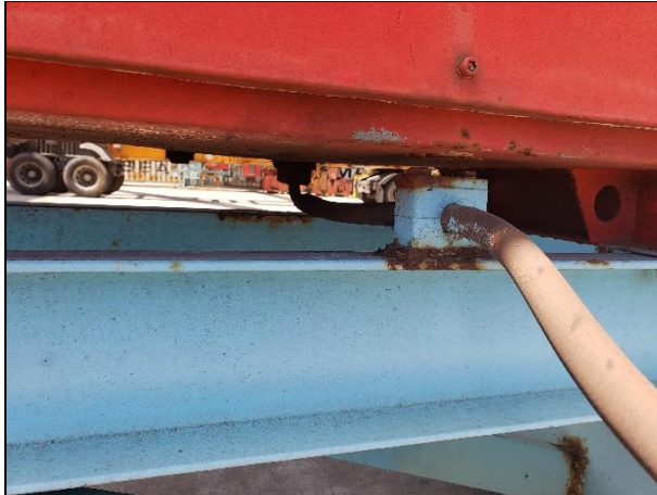
# item 5 – pontos com corrosão
