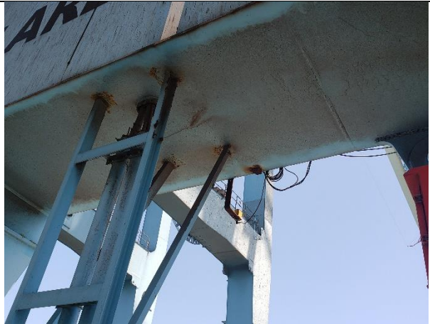
# item 5 – pontos com corrosão
