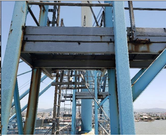
# item 49 – pontos de corrosão plataforma de manutenção
