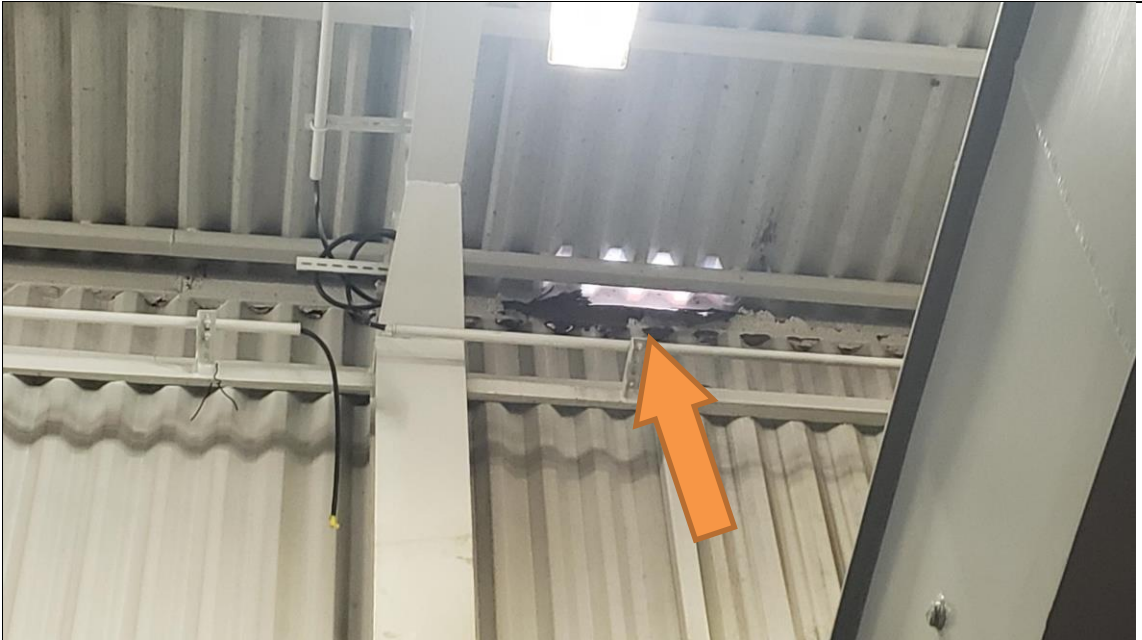
# item 29 – ponto de corrosão lado interno na sala de maquinas
