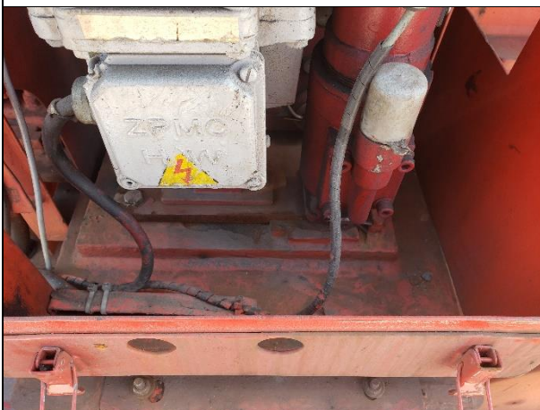
# item 5 – pontos com corrosão
