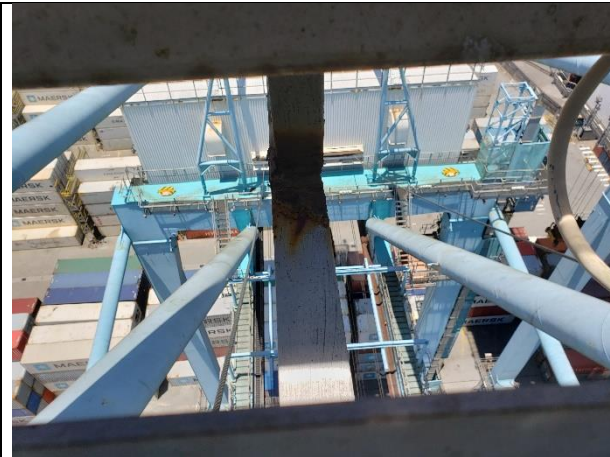
# item 54 – pontos de corrosão
