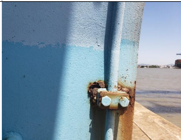
# item 5 – pontos com corrosão
