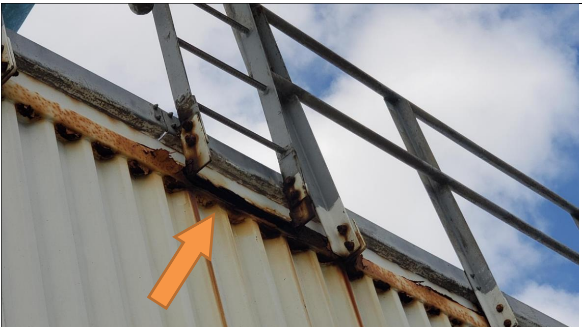
# item 29 – ponto de corrosão lado externo na sala de maquinas
