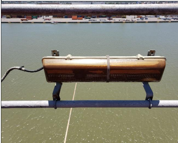
# item 49 – pontos de corrosão suporte de luminaria
