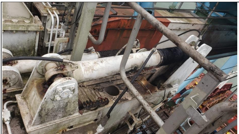
# item 40 – vazamento de óleo no cilindro de tensionamento do trolley
