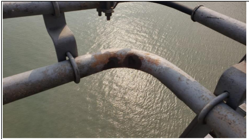
# item 51 – corrosão acentuada no corrimão da passarela
