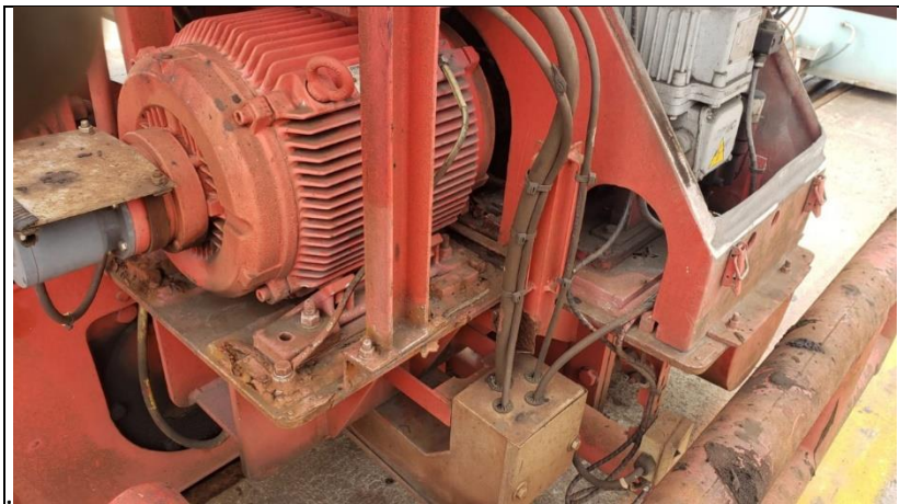
# item 5 – corrosão acentuada no gantry, base dos motores elétricos.
